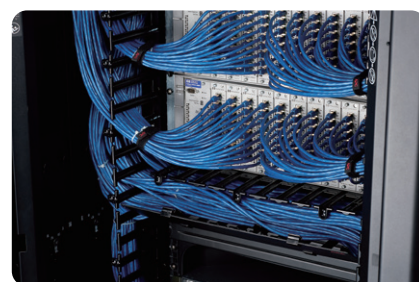
水平ケーブルマネージャ (AR8600) カバーをはずした状態
